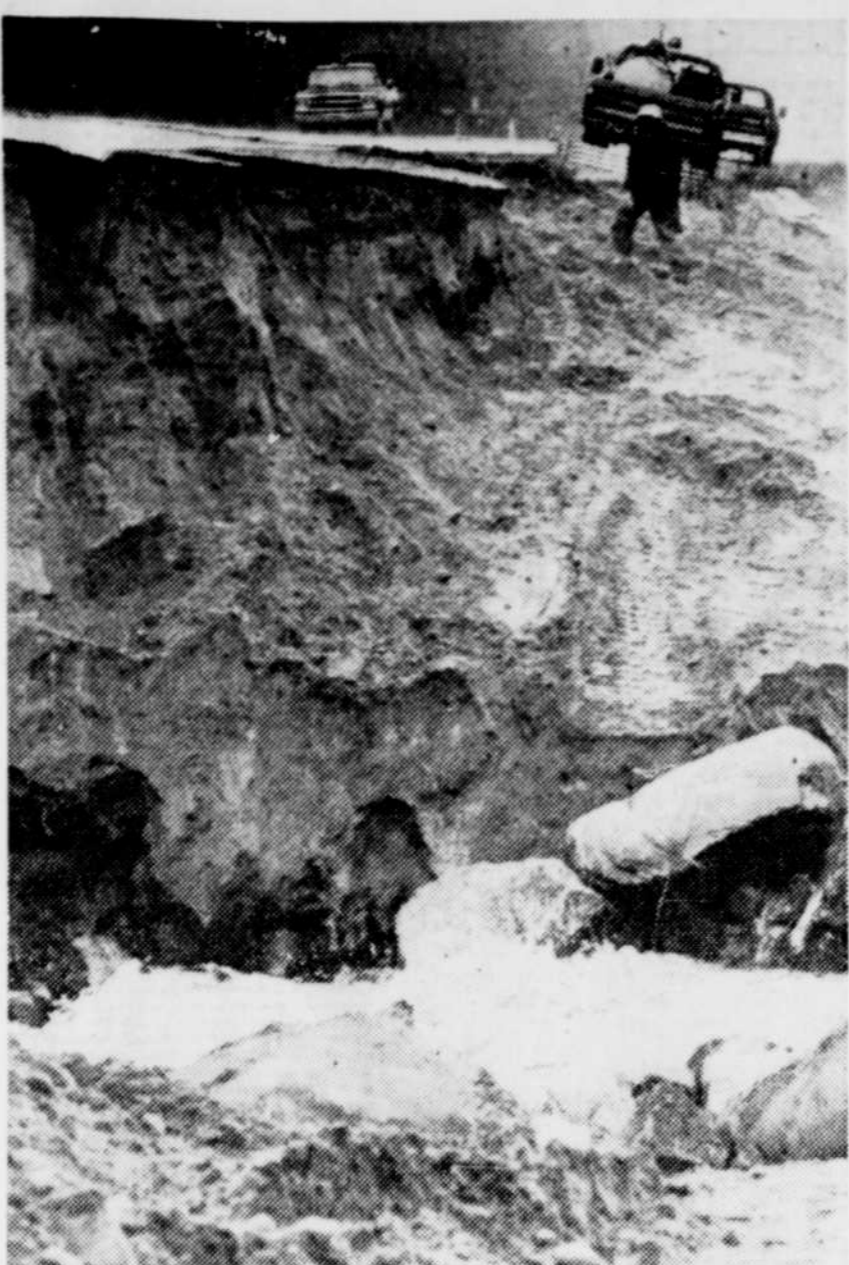
La pluie et les crues du dégel printanier ont miné la chaussée sur une distance de 30 à 40 pieds.
