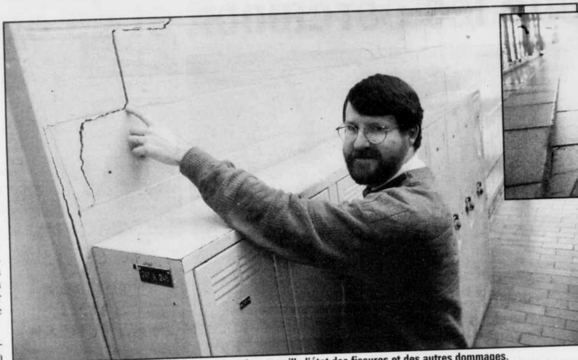
Bien qu'il n'y ait pas de danger immédiat, la direction surveille l'état des fissures et des autres dommages.
