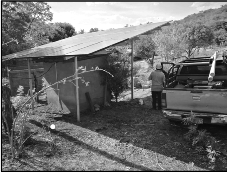
Eighteen solar panels for Las Pozas water grid (Photo: Elmer Zelaya Blandón)
