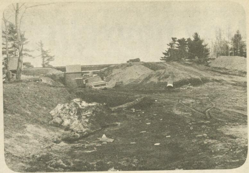
Comme on peut le constater ci-dessus, les travaux au tunnel des Estacades avancent à grands pas et d'ici peu, le tout pourra être ouvert à la circulation. (Photo L'Hebdo Jean Thibeau)
