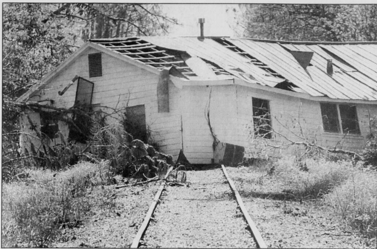
Au Mississippi, à Pass Christian, l'ouragan Katrina a laissé cette maison sur le chemin de fer, comme on pouvait toujours le constater hier, trois mois après le passage de l'ouragan qui a fait plus de 1300 morts.
