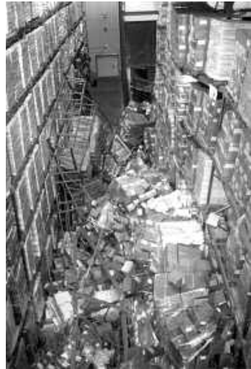
Figure 3. Effondrement d'un palettier (Photo : CSST)
