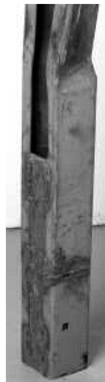
Figure 57. Montant endom- magé et réparé par une soudure à l'électrode (Photo : Maurice Vézinét)
