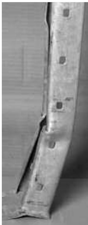
Figure 52b. Même montant endommagé (Vue de côté)
