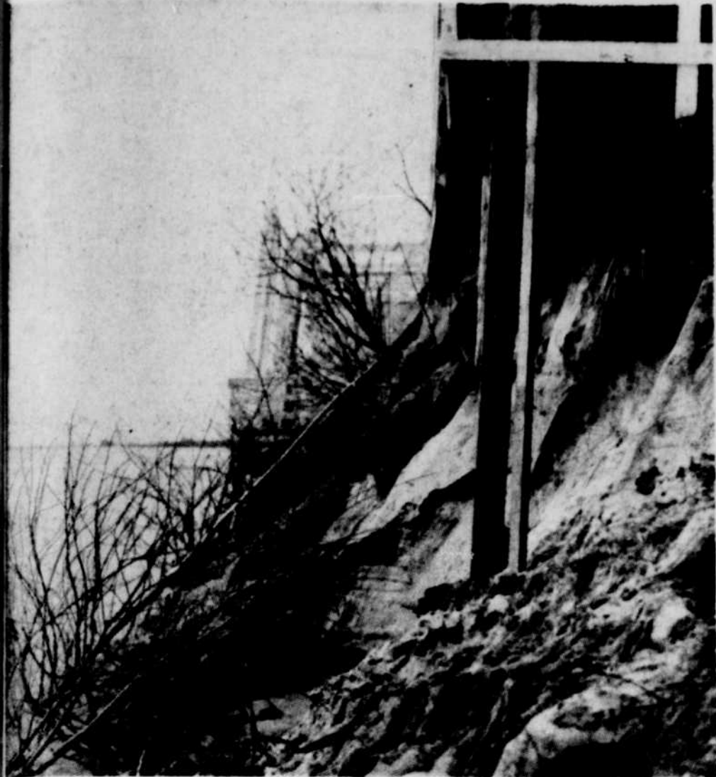
DES POTEAUX temporaires ont dû être installés en vitesse pour retenir cette passerelle à la suite d'un éboulement provoqué par le passage de l'Ivernia. Cette passerelle est sur la propriété de M. F.-C. Furlatt.
