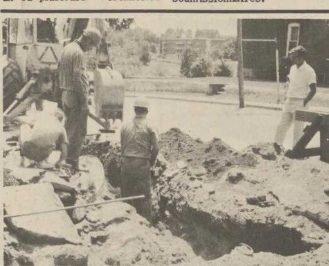
NOUVEAUX FEUX DE CIRCULATION-- Des employés de la firme Beau-Val de Ville Jacques-Cartier exécutent présentement des travaux d'excavation en vue de l'installation prochaine de nouveaux feux de circulation à l'intersection des rues Principale et James, à Cowansville. Ces travaux d'excavation se termineront aujourd'hui. L'érection des poteaux métalliques supportant les feux de circulation et les installations électroniques seront exécutées par les employés de la Voirie provinciale dans quelques jours. Les nouveaux feux de circulation seront en opération dans environ un mois. (Photo Studio Eclair, Cowansville)
