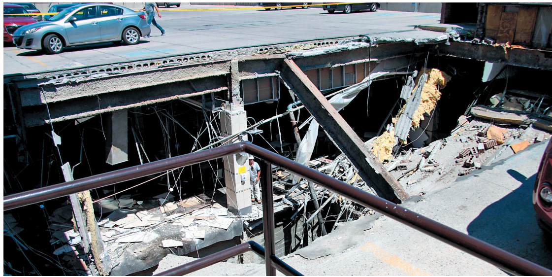
L'effondrement du toit du centre commercial a laissé un trou de 12 mètres sur 24.
