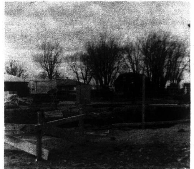
EXCAVATION. — Les travaux d'excavation sont en cours pour l'agrandissement de l'école Sacré-Coeur de Princeville. La réalisation de ce projet amènera des dépenses de l'ordre de $1,350,000. Le contrat a été donné à la firme Conrad Lessard de Thetford. La photo nous donne une idée de l'importance des travaux en cours sur le chantier.
