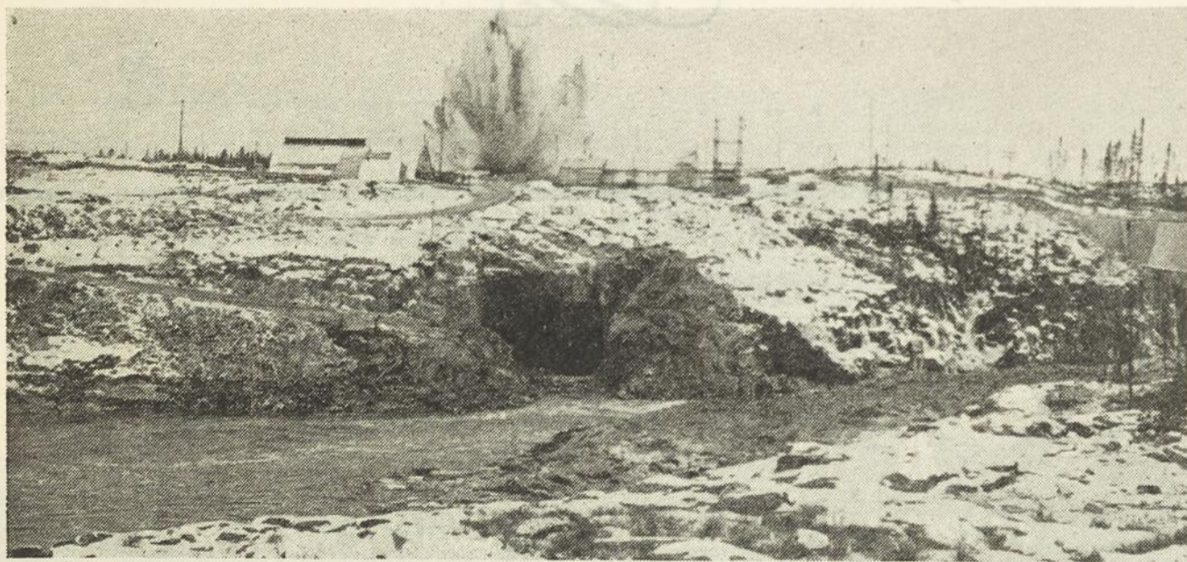
La deuxième détonation ouvre l'autre orifice du tunnel de 35 pi. de diamètre
