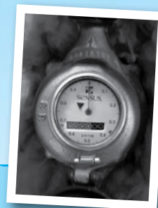
Image d'un compteur d'eau
