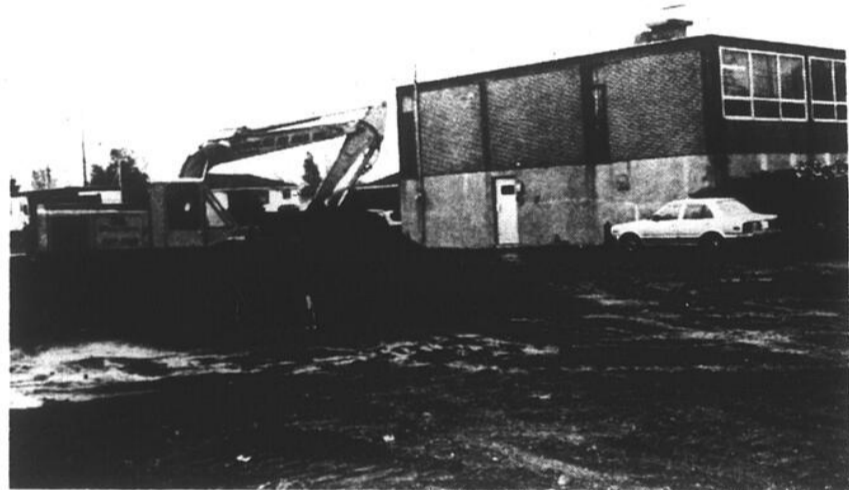
Les travaux de construction du Centre administratif de Saint-Luc ont débuté mercredi dernier. (Photos guy LE SIEUR)
