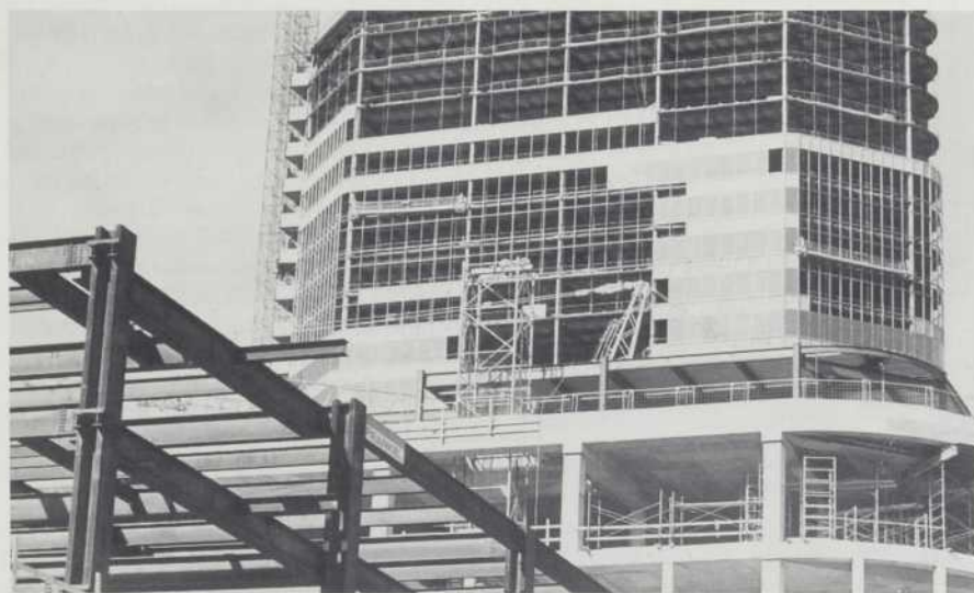
La construction de la première partie du Centre Eaton a été entreprise à Toronto. Coût prévu: $200,000,000. Le magasin à rayons couvrira 1,100,000 pi. ca.
