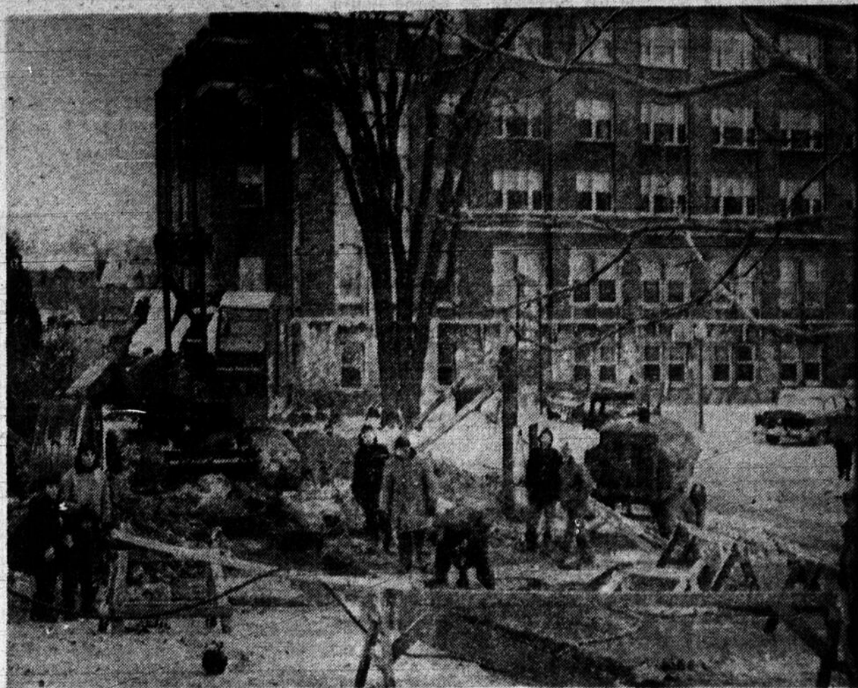
INONDATION, RUE LACOMBE — Les employés de la Ville s'évertuent à arrêter une inondation qui s'est produite hier après-midi, en face de l'hôpital St. Mary's, rue Lacombe, à Côte-des-Neiges, par suite de la rupture d'une conduite de 12 pouces de diamètre. La pelle mécanique qu'on voit à gauche est responsable de l'accident. En effet, la lourde pelle d'acier a accidentellement brisé le gros tuyau. La police rapporte que quelques caves environnantes ont été partiellement inondées. (Photo "Montréal-Matin", par David Bier)
