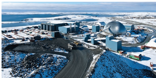
LÉONARD 2017 – ÉNERGIE OPTIMISATION DE LA CENTRALE DE COGÉNÉRATION – MINE D'OR DE MEADOWBANK
