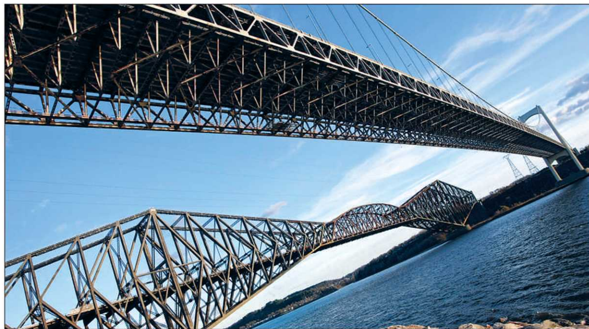
Selon les prévisions du ministère, lesquelles ont été établies à partir d'un logiciel, les débits de circulation sur les ponts demeureront au niveau de ceux de 2006 jusqu'en 2016. — PHOTO LE SOLEIL, LAETITIA DECONINCK
