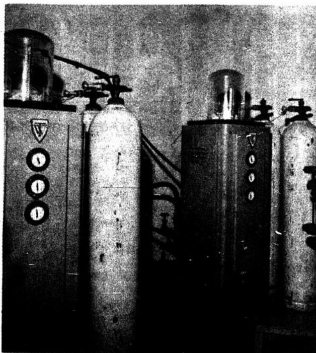
"...le chlore est ajouté selon une base horaire calculé selon la moyenne de consommation..."
