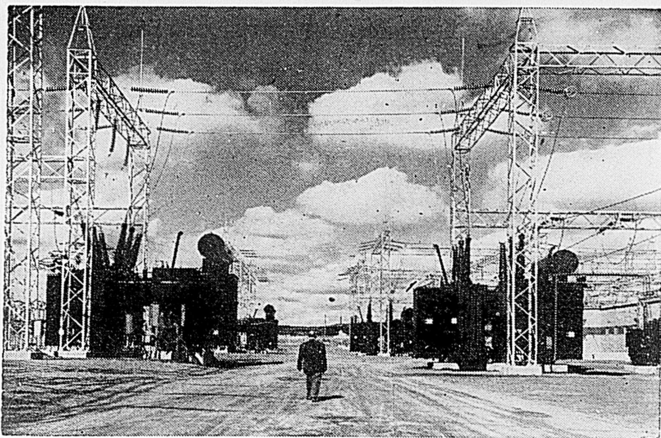
Le poste Charlesbourg à Québec qui reçoit l'énergie de Bersimis à 300.000 volts et la transforme à 230.000 volts. On y retrouve un des plus gros transformateurs jamais installés au Canada.
