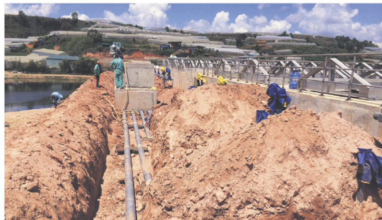
EXP: À DI AN AU VIETNAM, CONCEPTION ET SURVEILLANCE D'UNE NOUVELLE USINE DE TRAITEMENT DES EAUX USÉES ET D'UN IMPORTANT RÉSEAU D'ÉGOUT PRIMAIRE
