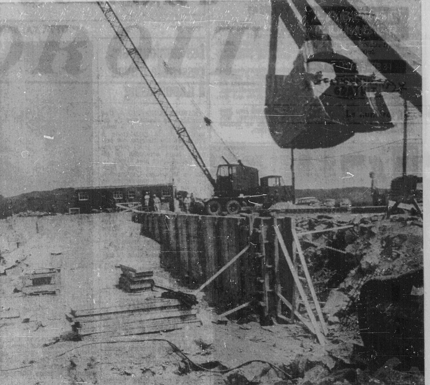
COUVENT EN CONSTRUCTION — La construction du couvent Notre-Dame-du-Bon-Conseil est commencée depuis quelques semaines. Le coût de ce nouveau couvent, de la congrégation des RR. SS. Grises de la Croix, à Sudbury, est de $750,000. Dans la photo du haut on peut voir le travail des grosses pelles mécaniques. Dans la photo de gauche, un camion transporte de longues poutres d'acier qui serviront à la structure de l'édifice.
