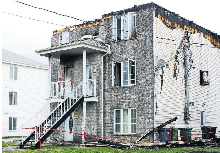
Trois familles se sont retrouvées à la rue à la suite de l'incendie suspect qui a ravagé cet immeuble à logements de l'avenue Jacques-Cartier, à Saint-Pie. Photo Courtoisie
