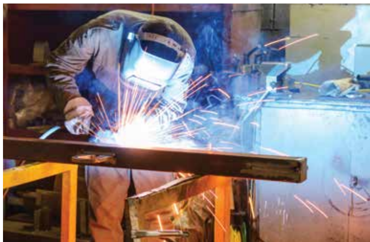
L'absence d'écran de protection lors des travaux de soudure augmente les risques de blessure et d'incendie.
