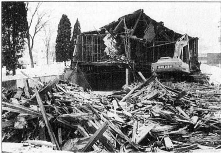
DEMOLITION - L'Atelier de musique de Jonquière a été complètement rasé par une grue, jeudi, comme en témoignent cette photo prise par la présidente directrice générale Pauline Gauthier.
