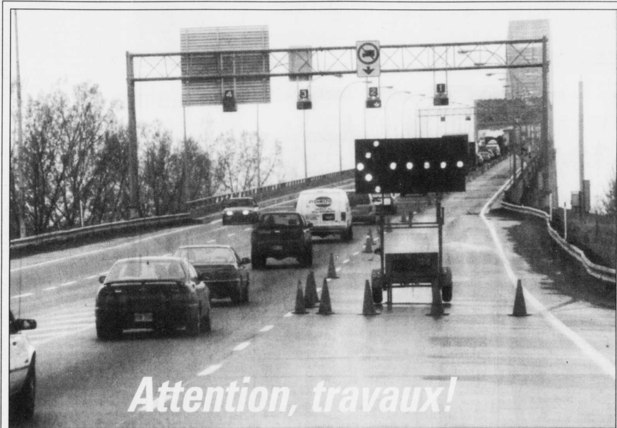
Pour limiter la perturbation de la circulation, le ministère des Transports annonce le nouvel horaire des travaux de nettoyage de la structure du pont Lavolette pour les prochains jours. Aujourd'hui, une voie sera fermée en direction nord, de 4 h 30 à 15 h, et samedi, de 5 h à 20 h. Dimanche et lundi, une voie subira le même sort en direction sud, de 5 h à 20 h. Par ailleurs, la fermeture de la route 132, entre l'intersection du boulevard Port-Royal et l'ancienne voie ferrée à Saint-Groire, pour fins de travaux d'aqueduc et d'asphaltage, est reportée d'une semaine. ■
