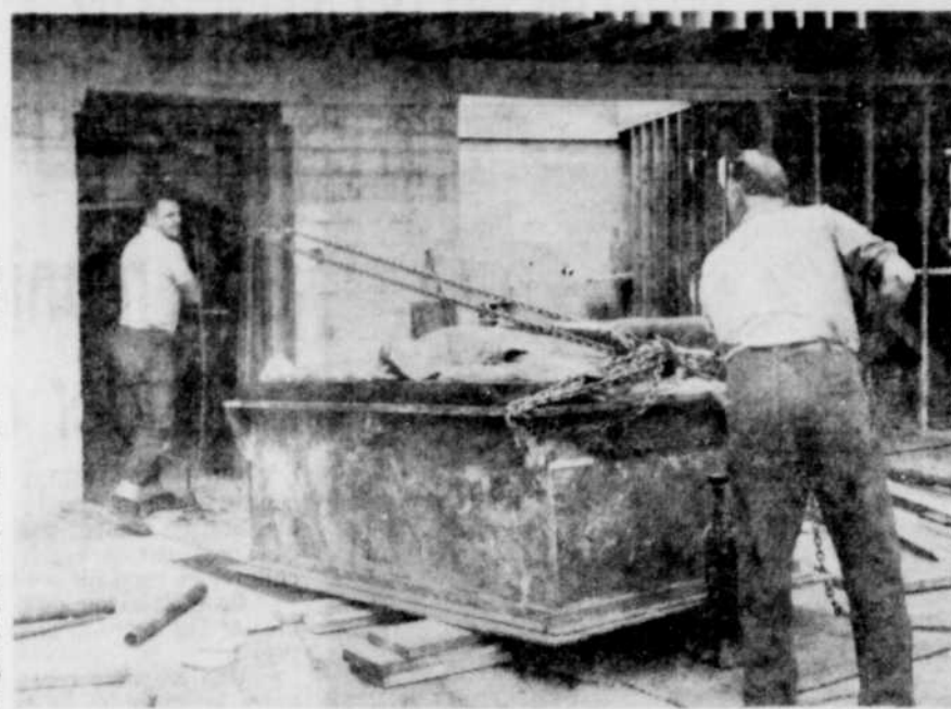
PORTE "LOURDE" — La porte de voûte du nouvel édifice à la Caisse populaire St-Jean-Baptiste de Drummondville a causé des soucis aux ouvriers chargés de la transporter et de l'installer dans l'espace prévu à cette fin. La porte et le cadre pèsent quelque 15,000 livres et ce ne fut pas une mince tâche que de décharger ce matériel du camion-remorque qui le transportait et de le diriger près de l'orifice que l'on aperçoit ci-dessus. Le travail se poursuit depuis deux jours et ce n'est qu'aujourd'hui qu'on pourrait compléter l'installation de la porte, laquelle est fabriquée d'acier solide de 11 pouces d'épaisseur. (Photo La Tribune, Drummondville)
