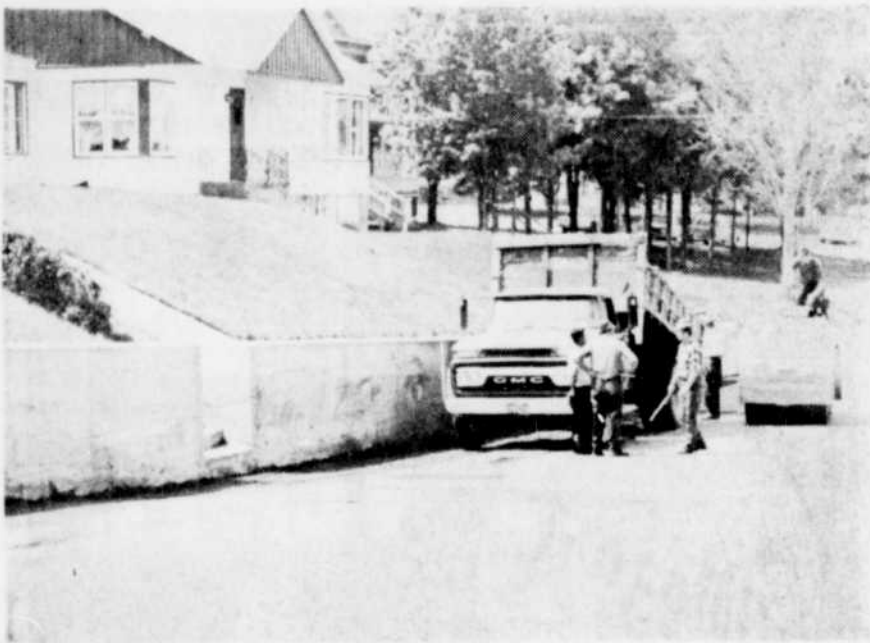
TRAVAUX A EAST BROUGHTON — Les employés de la Voirie municipale à East Broughton procèdent présentement au pavage des abords de la rue Principale de l'endroit. (Photo Studio J. H. Gagnon, East Broughton)
