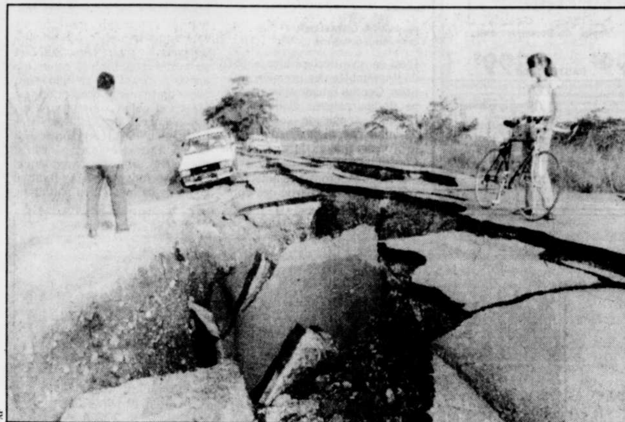
Un automobiliste et une cycliste observent les crevasses d'une route de Batan, à 50 km à l'est de San Jose, provoquées par le séisme de 7,4 sur l'échelle de Richter qui a eu lieu lundi au Costa Rica ainsi qu'au Panama. Au moins 74 personnes sont mortes et 1000 autres blessées à cette occasion.
