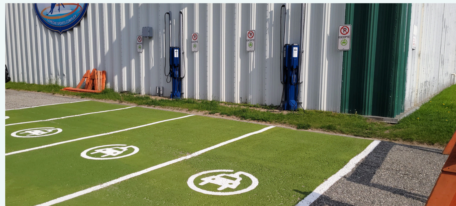
Bornes de recharge électrique
