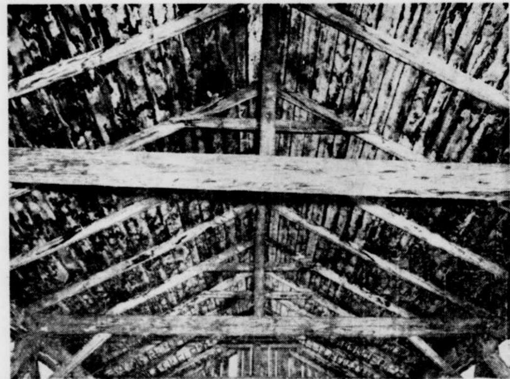
L'âge du pont de Coaticook Nord ne surprend point. L'état de sa toiture ne nous laisse aucun doute à ce sujet.
