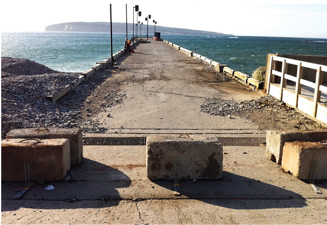
Les employés municipaux qui ont détruit la barricade ont laissé sur place quelques blocs de béton pour bloquer l'accès aux véhicules.
