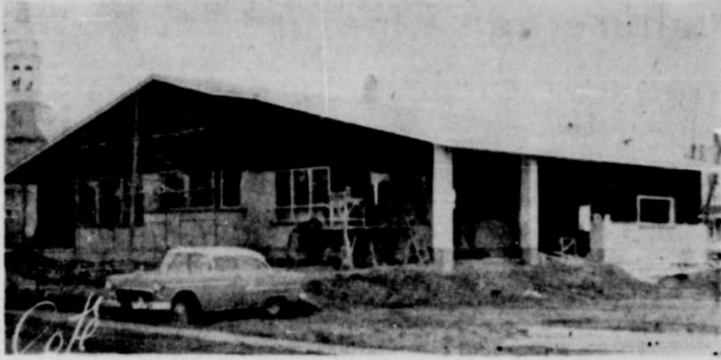
LA CONSTRUCTION est active au village de Sainte-Ursule. Voici l'une des maisons en voie de construction; il s'agit de la future demeure du notaire Charles Milot, de l'endroit.
