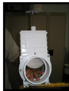
Figure 2.2 Valve permettant l'évacuation du contenu d'un bassin de rétention
