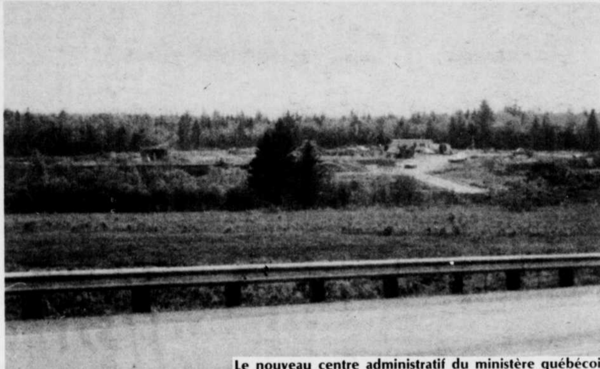
Le nouveau centre administratif du ministère québécois des Transports qui a été mis en chantier à l'intersection de l'autoroute 10-55 et du rang St-Joseph prend lentement forme.
