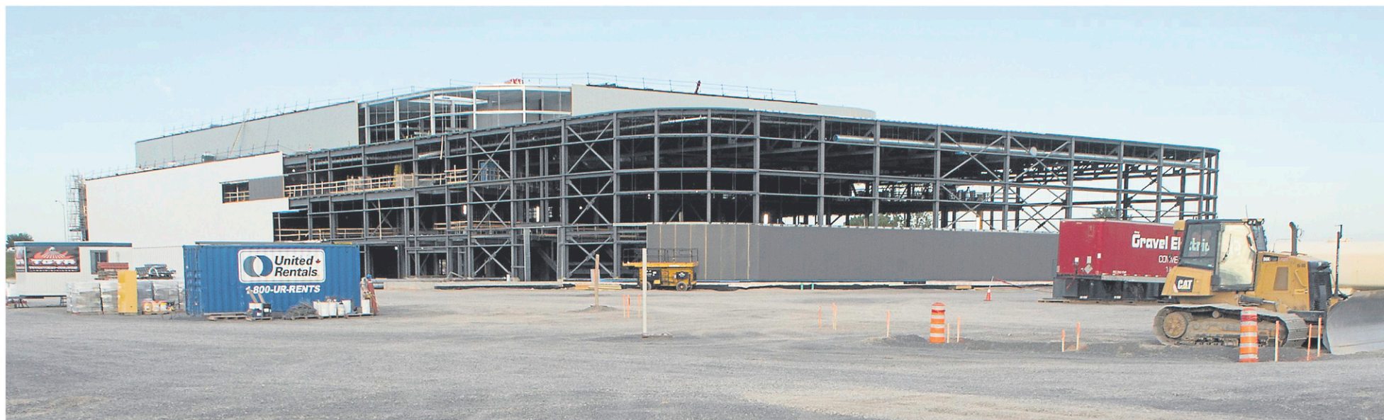
Le nouveau colisée en construction à Trois-Rivières suscite de l'intérêt. — PHOTO:SYLVAIN MAYER
