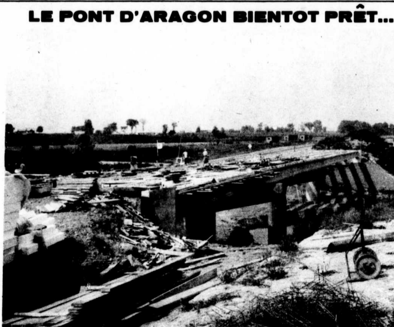
Les travaux sur le pont d'Aragon entre Thurso et Masson avancent à grands pas et il est fort probable que les usagers de cette route pourront emprunter ce pont vers le mois de septembre au tout début, d'après nos informations officielles, du directeur des travaux, M. Henri Gervais.
