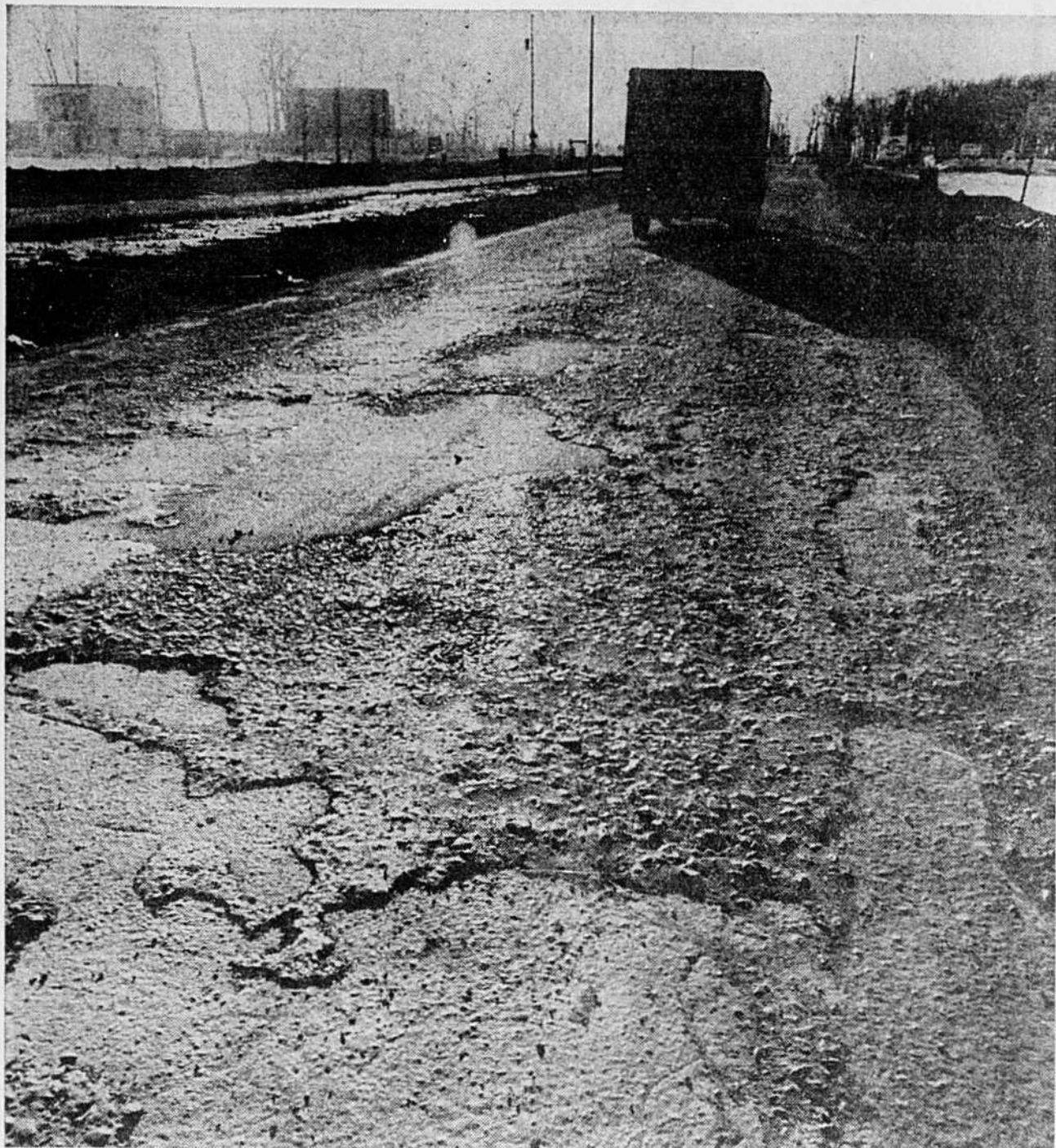
Voilà l'aspect de la rue Sherbrooke, aux abords du pont LeGardeur, dans l'Est de Montréal. La rue n'a pas été refaite depuis sa construction, en 1939. L'asphalte a depuis longtemps cédé la place au fonds pierreux que le dégel fait remonter en surface. La Voirie se contente de remplir les trous de gravier...
