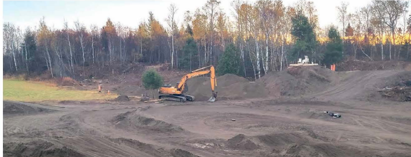
Cette piste de motocross, possiblement aménagée en territoire agricole, donne bien des maux de tête à André Allard. Photo : Courtoisie
