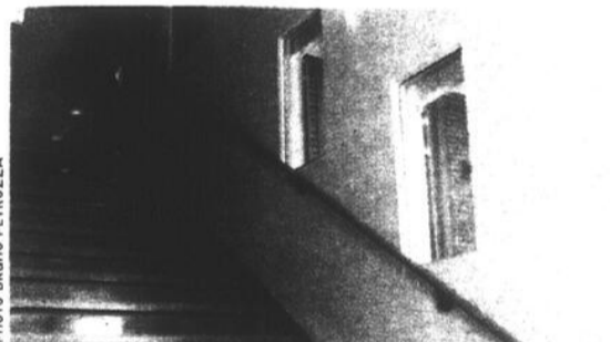
L'escalier au mur coupe-feu permet de descendre de l'étage des salles de cinéma pour se retrouver au rez-de-chaussée et ainsi quitter l'immeuble.
