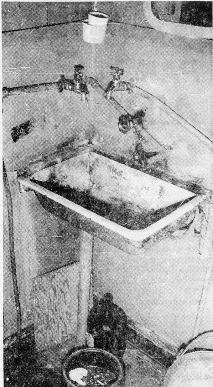
EVIER PUBLIC — Les visiteurs et les prisonniers doivent utiliser ce magnifique évier qui orne l'hôtel de ville de Buckingham. Heureusement, avec la construction projetée d'un nouvel hôtel de ville, cette monstruosité disparaîtra. (Photo Champlain Marciel)
