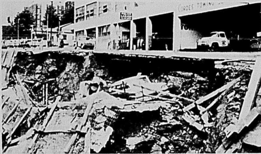
LA RUE DESCEND DANS LA CAVE — Une excavation pratiquée en bordure du pavé a entraîné l'effondrement de la 5 e avenue, sur une largeur de 90 pieds, à Seattle. Un vendeur de 60 ans, M. Frank J. Watson, qui prenait place dans son auto, a été légèrement blessé quand son véhicule a fait une chute de 12 pieds.
