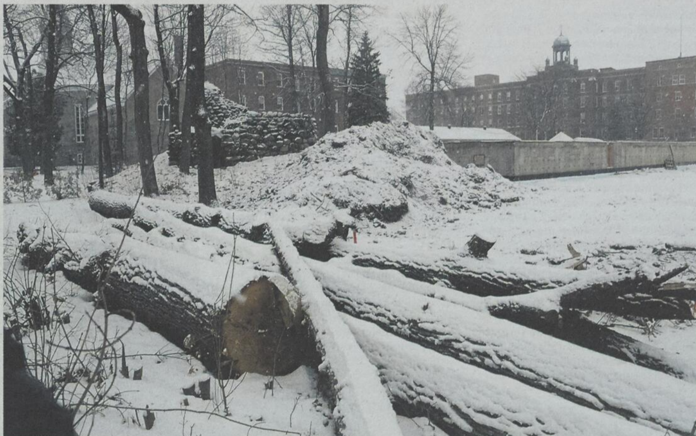
Un immeuble résidentiel est actuellement en construction sur l'ancien cimetière paroissial datant du milieu du 19 e siècle.
