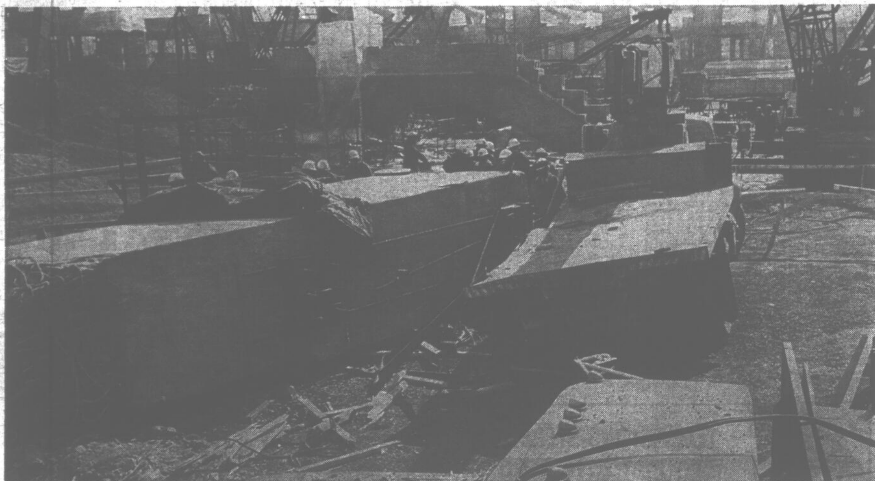
C'est à cet endroit que les voussoirs 101 et 102 de la console 19-A sont tombés, entraînant vers la mort quatre ouvriers. Les camions (que l'on aperçoit à droite) ne pourront être déplacés avant que les enquêteurs aient complété leur travail.
