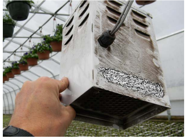
Photo 2 : Cage de sonde climatique à nettoyer.
