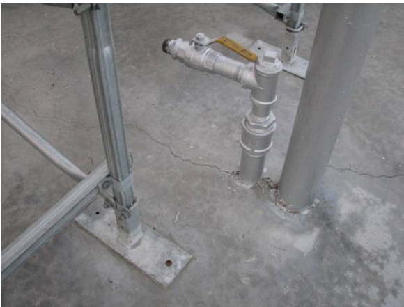
Photo 3 : Pied de table, poteau de serre et sortie d'eau bien nettoyés et désinfectés.
