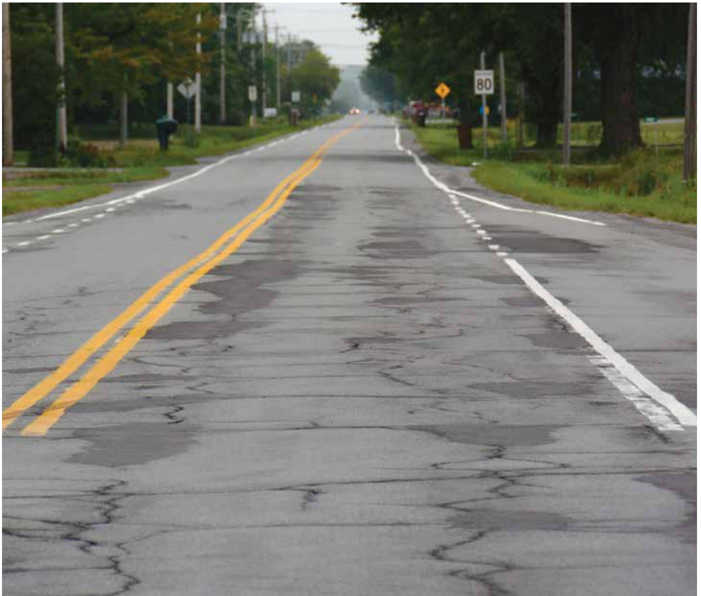
FIGURE 5 LES NOMBREUSES RÉPARATIONS DIMINUENT LE CONFORT DE ROULEMENT
