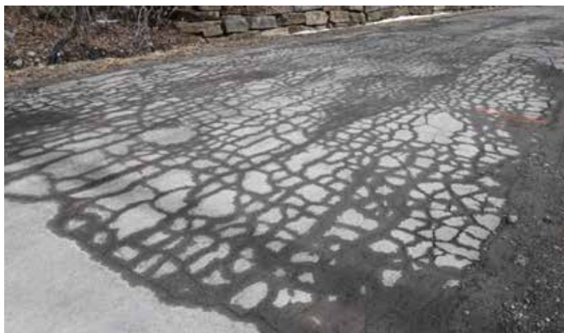
Figure 3. État de la structure de chaussée avant les travaux
