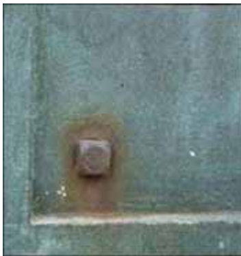
Exemple de corrosion bi-métallique
