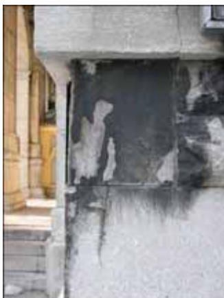
Croûte noire de sulfate de calcium et desquamation de la pierre sur une zone abritée de la pluie. Exemple sur une pierre calcaire.
