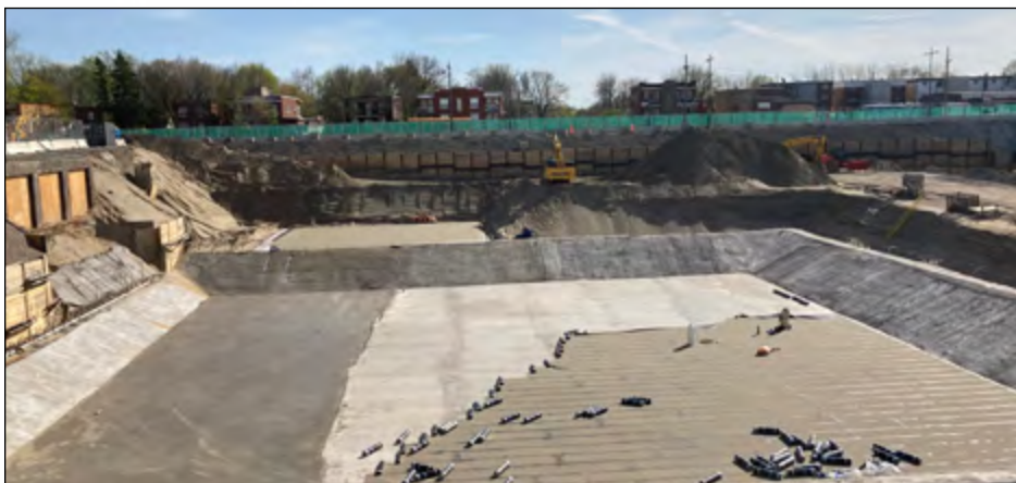
Les travaux d'excavation de la première partie du bâtiment des soins critiques vont bon train.
