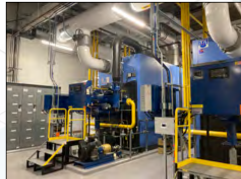
Dotée d'équipements à la fine pointe, la nouvelle centrale d'énergie permettra d'approvisionner l'ensemble de l'hôpital en énergie.
