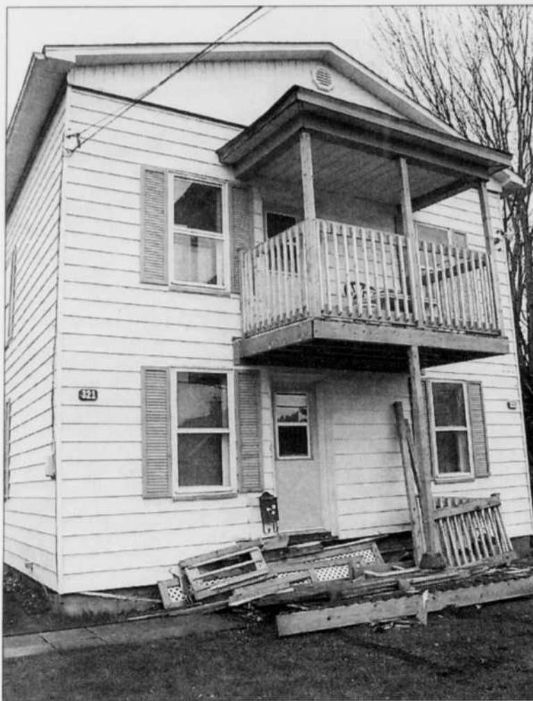
Prise en chasse par les policiers, la voiture dans laquelle voyageaient trois Cowansvillois a terminé sa course contre cette demeure.
