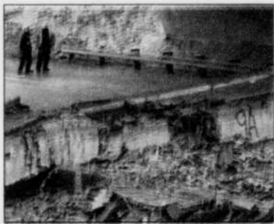
L'effondrement du viaduc de la Concorde, en 2006.
