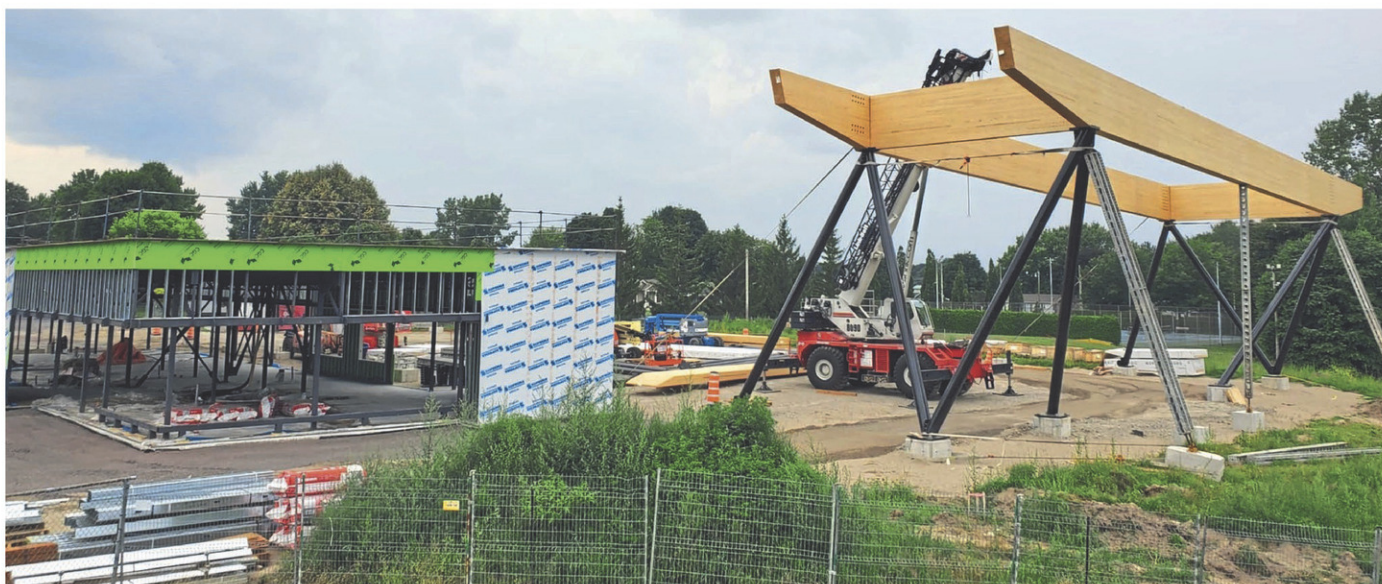
La construction de l'infrastructure multifonctionnelle de Terre-des-Jeunes est en cours. (Photo gracieuseté)
