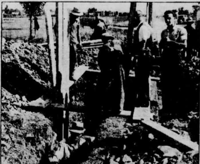
C'est à cet endroit, rue Sherbrooke est, en face du Mont-Saint-Antoine, que quatre ouvriers furent blessés hier, comme leur foreuse à air comprimé touchait une cartouche de dynamite, déposée là il y a quelques dix ans lors de la pose des tuyaux de renvoi pour les puisards. Les blessés, qui sont encore à l'hôpital, s'en retourneront dans leur famille dans quelques jours. La pierre que l'explosion lança fut projetée sur les jambes, les bras et dans la figure des victimes. — (Photo la "Patrie").
